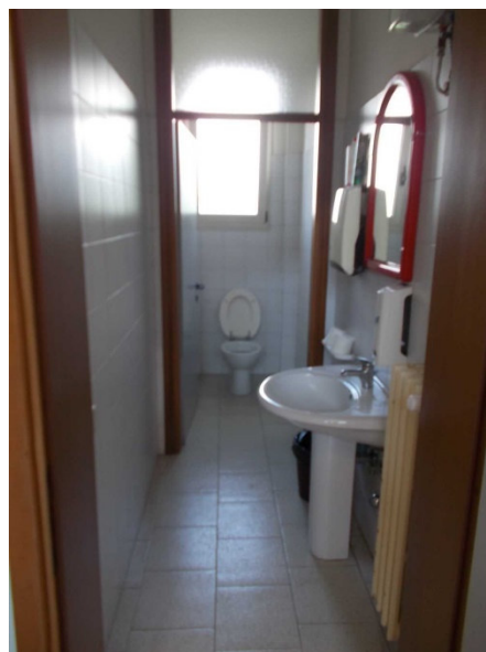
Dettaglio servizi igienici
