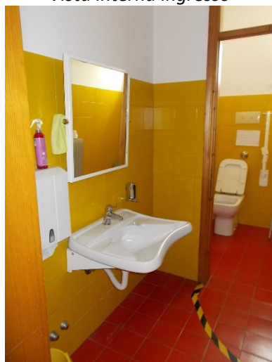
Dettaglio Servizi igienici
