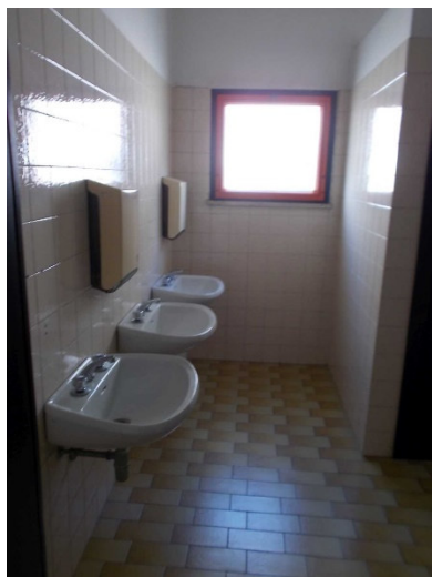
Dettaglio servizi Igienici
