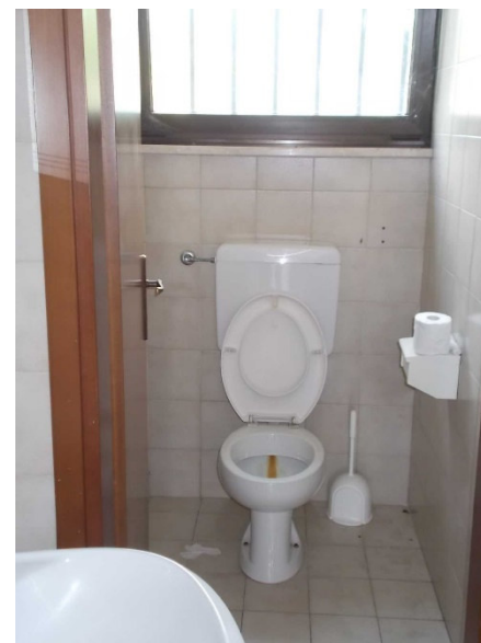
Dettaglio servizi igienici
