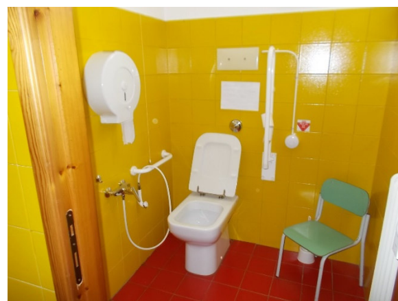
Dettaglio Servizi igienici
