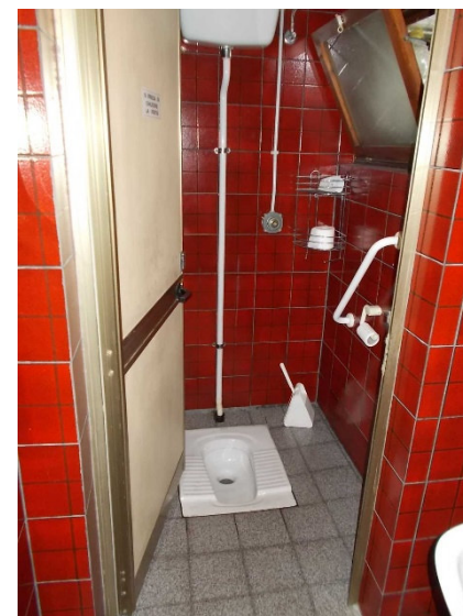
Dettaglio servizi igienici
